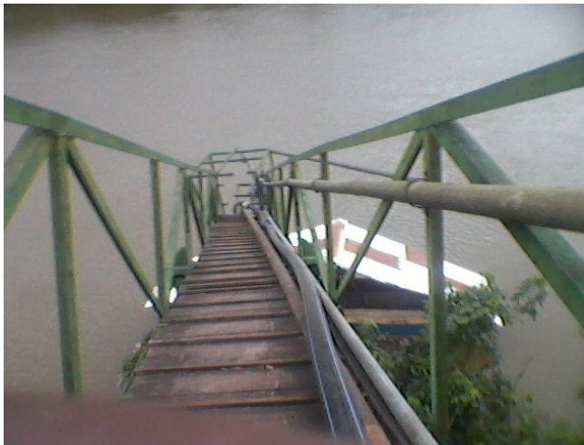
Station de captage d'eau à la SANGHA
