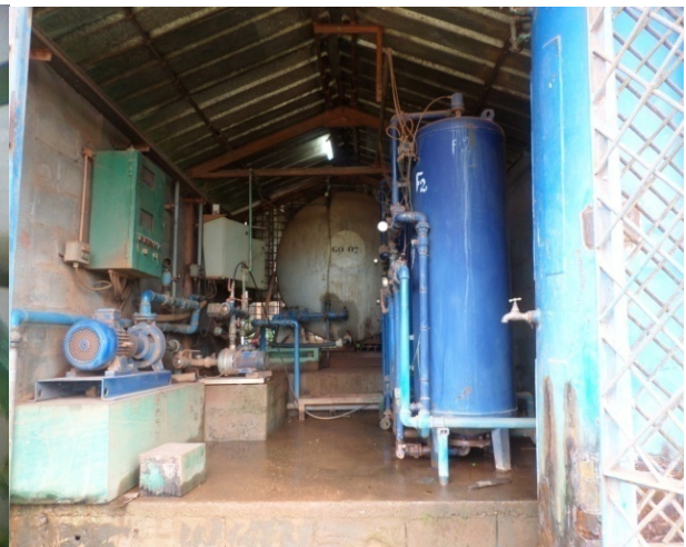
Appareil de potabilisation de l'eau
